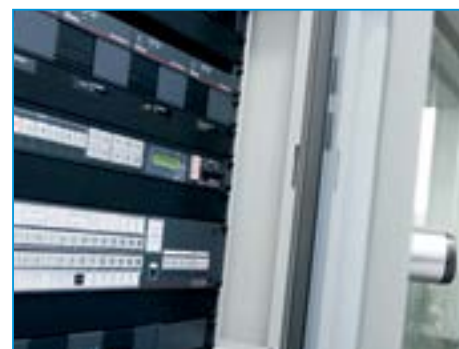
Serwerownie i szafy typu RACK
